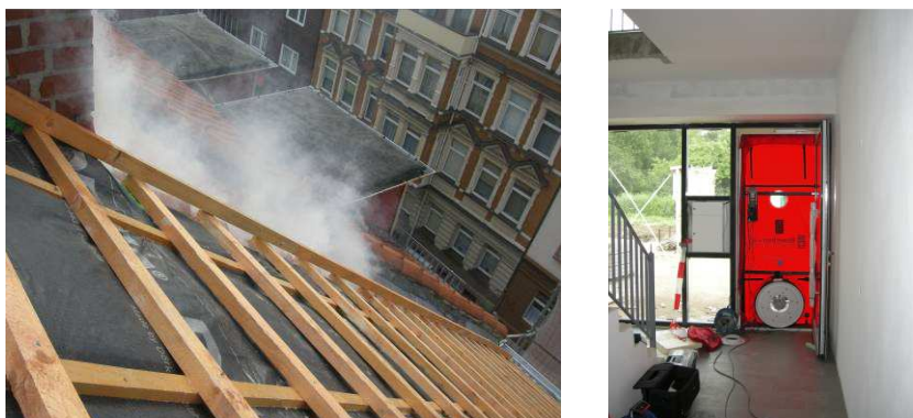
Abb. 10: Links: Der Nebel macht Mängel an den Verklebungen sichtbar. Rechts: Die Erzeugung des notwendigen Überdruckes erfolgte mit dem BlowerDoor Messsystem.
