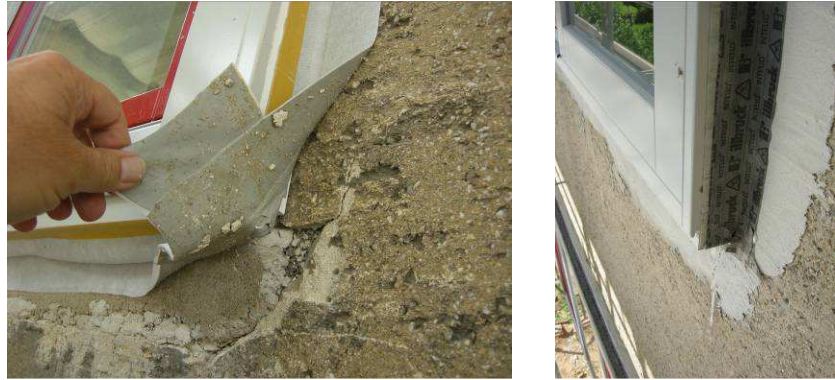
Abb. 4: Links: Bei der Qualitätsüberwachung wurde festgestellt, dass das elastische Material zwischen Fenster und Putz auf einen löchrigen, nicht tragfähigen Putz aufgebracht wurde. Rechts: zur Sanierung wurde der Untergrund durch eine Spachtelung verfestigt und Fenster und Putz wurden mittels einer Verklebung luftdicht miteinander verbunden.
