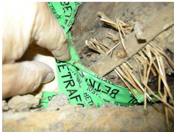
Abb. 7: Bei der Ausbildung der Abdichtung zwischen den Deckenbalken hätte zunächst ein haftfähiger Untergrund hergestellt werden müssen.
