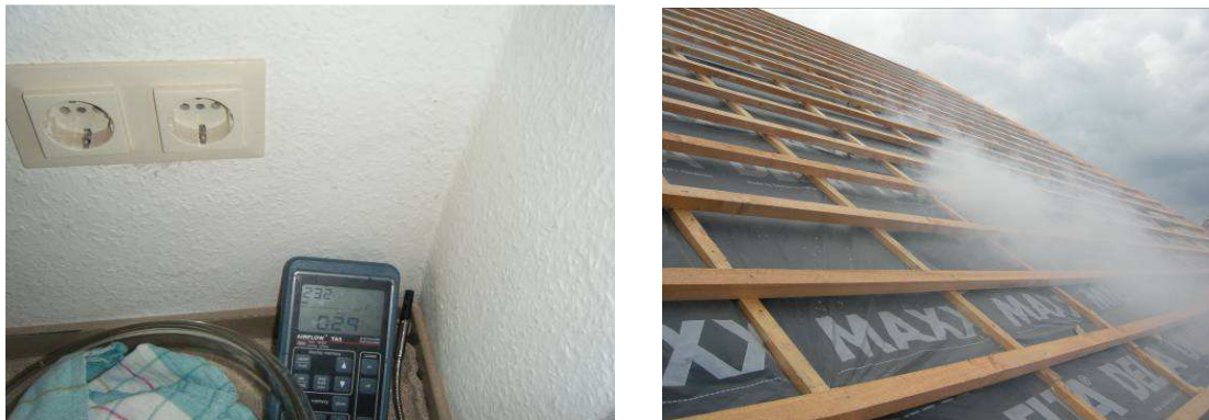
Abb. 17: Links: Das Gebäude hat massive Wände und Stahlbetondecken, deshalb wurde in der Planungsphase erwartet, dass die Bodenanschlüsse dicht sind, es zieht aber aus sehr vielen Bodenanschlüssen. Rechts: Nebelaustritt aus der Dachfläche. Nach der Sanierung waren augenscheinlich im Dachbereich die größten Leckagen verblieben.
