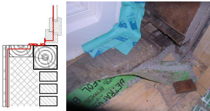
Abb. 13: Beispiel aus dem Jahr 2009: Führung der Luftdichtheitsebene von der Innendämmung eines Fachwerkgebäudes zum Fenster, hier wurden nur noch Klebebänder geliefert und lose in Baustaub verlegt.
