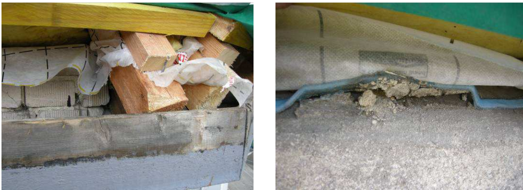
Abb. 9: Links: Auf dem Bild lässt sich die Führung der luftdichten Ebene nur erahnen. Rechts: Das schwächste Glied in der Kette gibt nach. Mal ist es die Verbindung zwischen Folie und Klebemittel und das andere Mal zwischen Klebemittel und Drenpелverputz.
