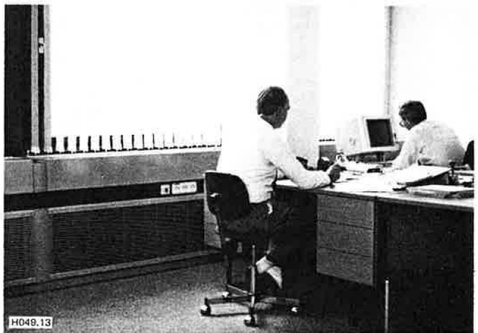
Bild 13: Quellluft-Induktionsgerät im Büroraum
